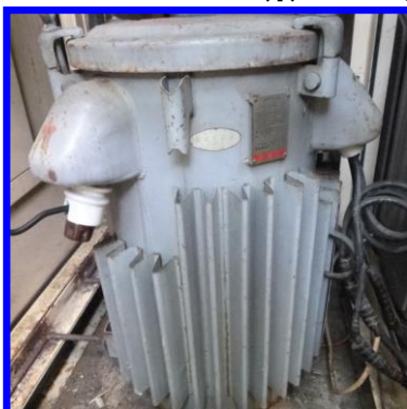
トランス（変圧器）
