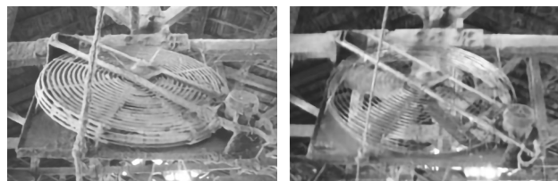
換気扇の掃除で風速が回復(左:前、右:後)
